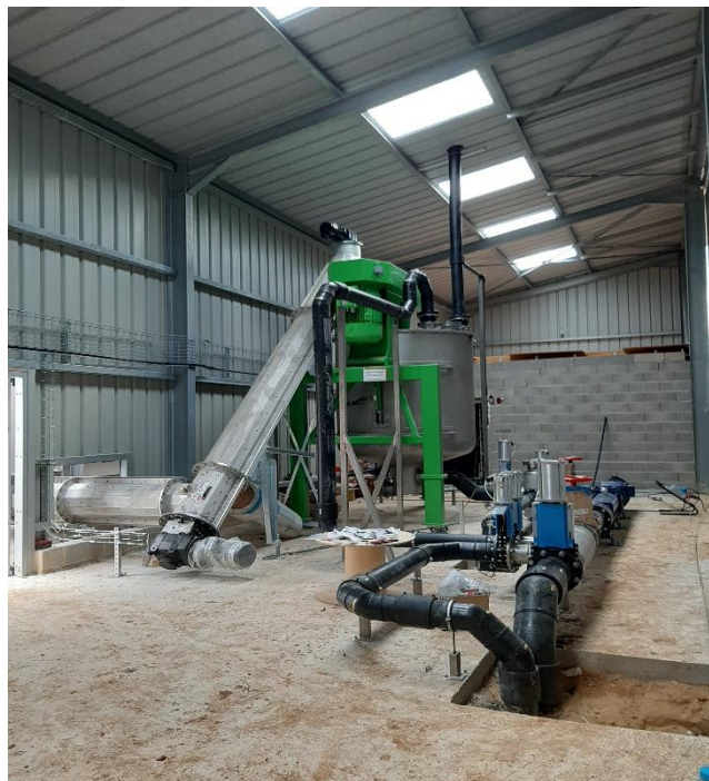
Figure 3 : Réservoir de mélange / dissolvant (Source : EnviTec Biogas)
