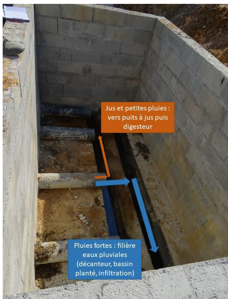
Figure 9 : Photo d'un regard de tri des eaux pluviales
